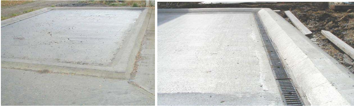
Abb. 16 + 17: Separater, betonierter Befüll- und Waschplatz der die anfallenden kontaminierten Flüssigkeiten über eine betonierete Rinne (links) oder Drainagegitter (rechts) zum Biofilter leitet (Fotos: ADAS)
