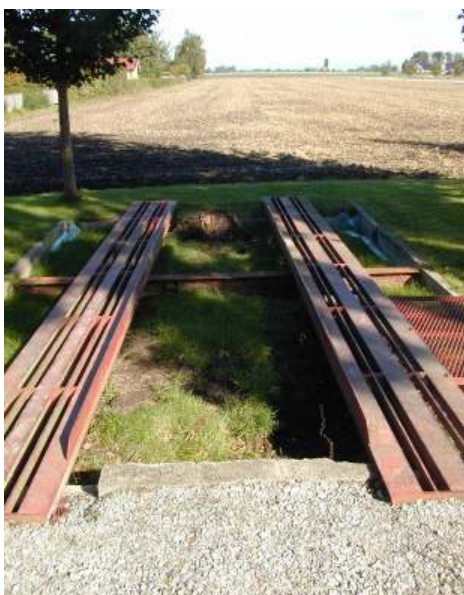
Abb. 11: Rampe über einem Biobed (Foto: Visavi)
