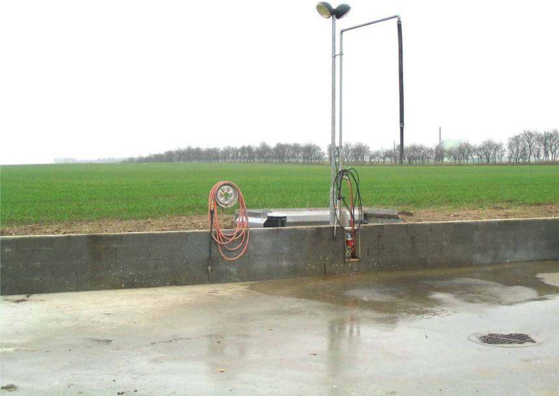
Abb. 15: Separater, befestigter Befüll- und Waschplatz mit entsprechender Ausrüstung, der die anfallenden kontaminierten Flüssigkeiten zum Biofilter leitet (Foto: DAAS)
