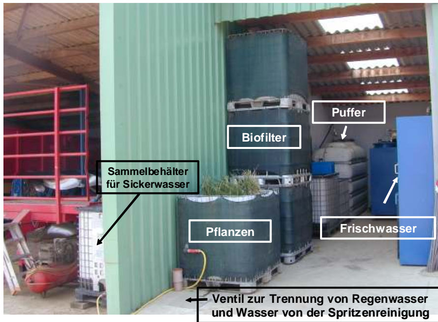
Abb. 32: Integrierter Befüll- und Waschplatz, ausgestattet mit einem modifizierten Biofilter mit 3 + 1 Einheiten (Foto: pcfuit). Der Überlauf der Pflanzeneinheiten befindet sich auf der Höhe der Wurzelzone der spezifischen Pflanzen. Das gesamte restliche Sickerwasser wird gesammelt
