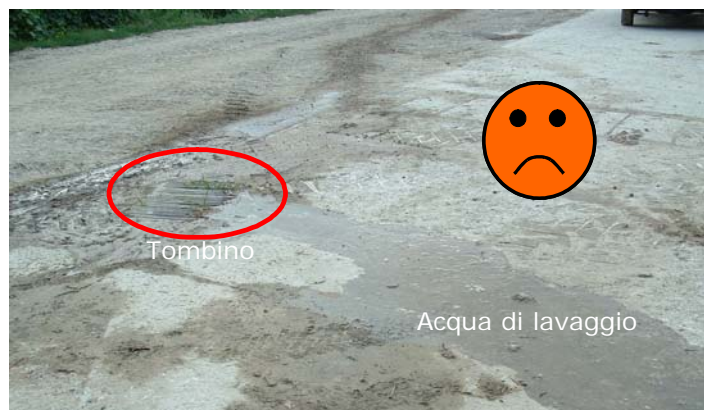
Fig. 64 – Acque di lavaggio immesse direttamente nella rete fognaria
