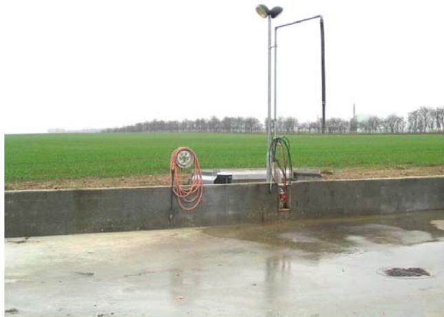
Figura 2 – Esempio di area attrezzata pavimentata, dotata di sistema per la raccolta delle acque contaminate da agrofarmaci e di tubazione per il riempimento dell'irroratrice che garantisce il non ritorno del prodotto chimico nella tubazione di mandata dell'acqua.
