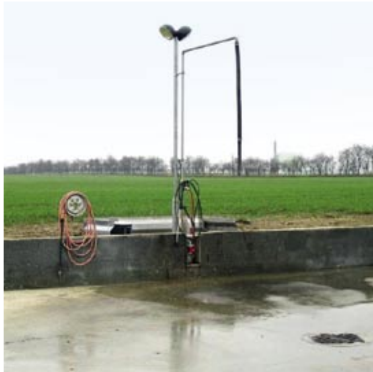
Figura 6 – Esempio di area attrezzata pavimentata, dotata di sistema per la raccolta delle acque contaminate da agrofarmaci e di tubazione per il riempimento dell'irroratrice che garantisce il non ritorno del prodotto chimico nella tubazione di mandata dell'acqua.
