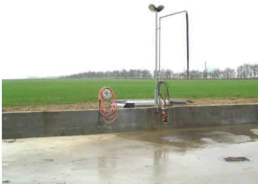
Fig. 15: Zona destinada al llenado y limpieza del pulverizador (hormigón). En esta instalación se observan además equipamientos específicos para el llenado y la limpieza, así como puntos de drenaje de las aguas contaminadas para su posterior tratamiento en el sistema de bio purificación (fuente: DAAS).
