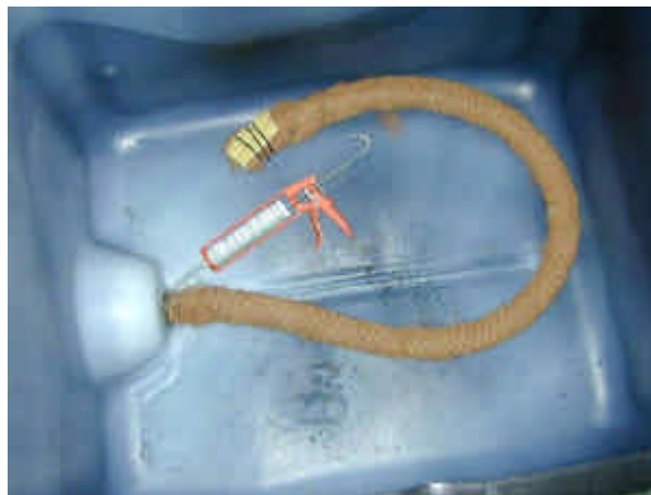
Fig 27: Tubería de drenaje en un biofilter.
