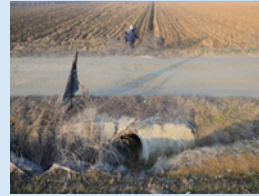
Direkter Gewässeranschluss über Abläufe (Wege/Rohre)
