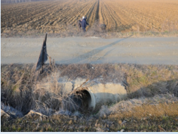
Versnelde afspoeling naar de waterloop door een afvoerbus
